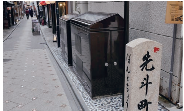
無電柱化事業で設置された地上機器は、場所に応じて覆い屋などで美化。先斗町通の入口部分の舗装は、シンボルである千鳥がデザインされている。
